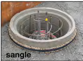
Une sangle autour des bandes maintiennent les bandes durant la phase de durcissement de la colle.
