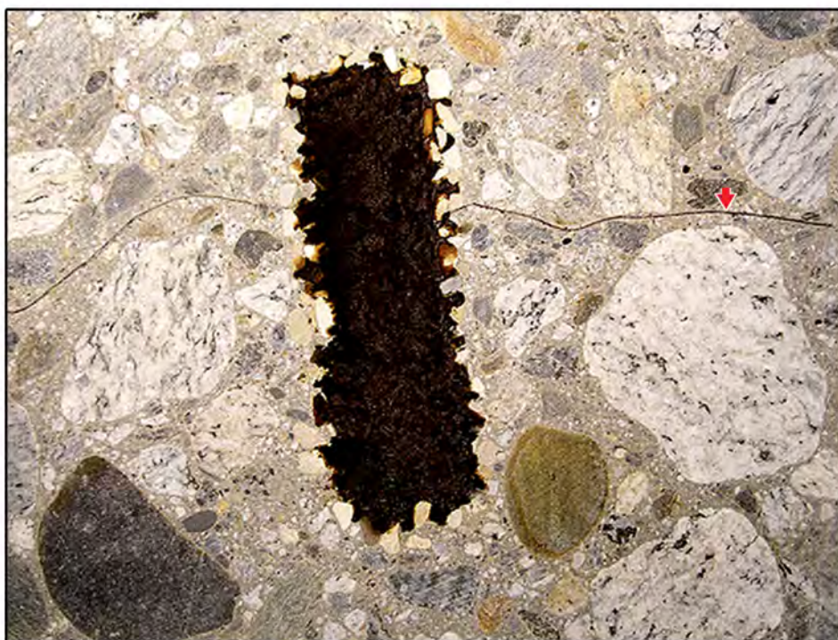
fissure de la reprise de bétonnage
